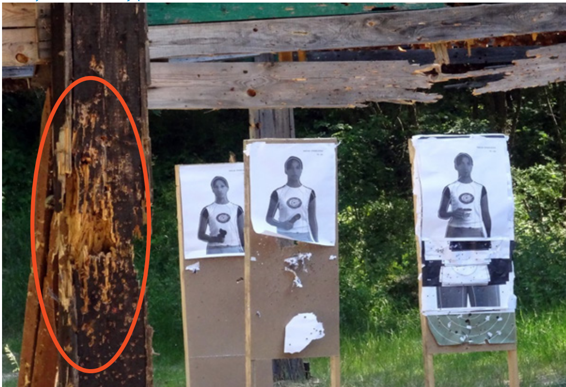
Zdjęcie nr 23 Znaczne ubytki w konstrukcji przeston.
